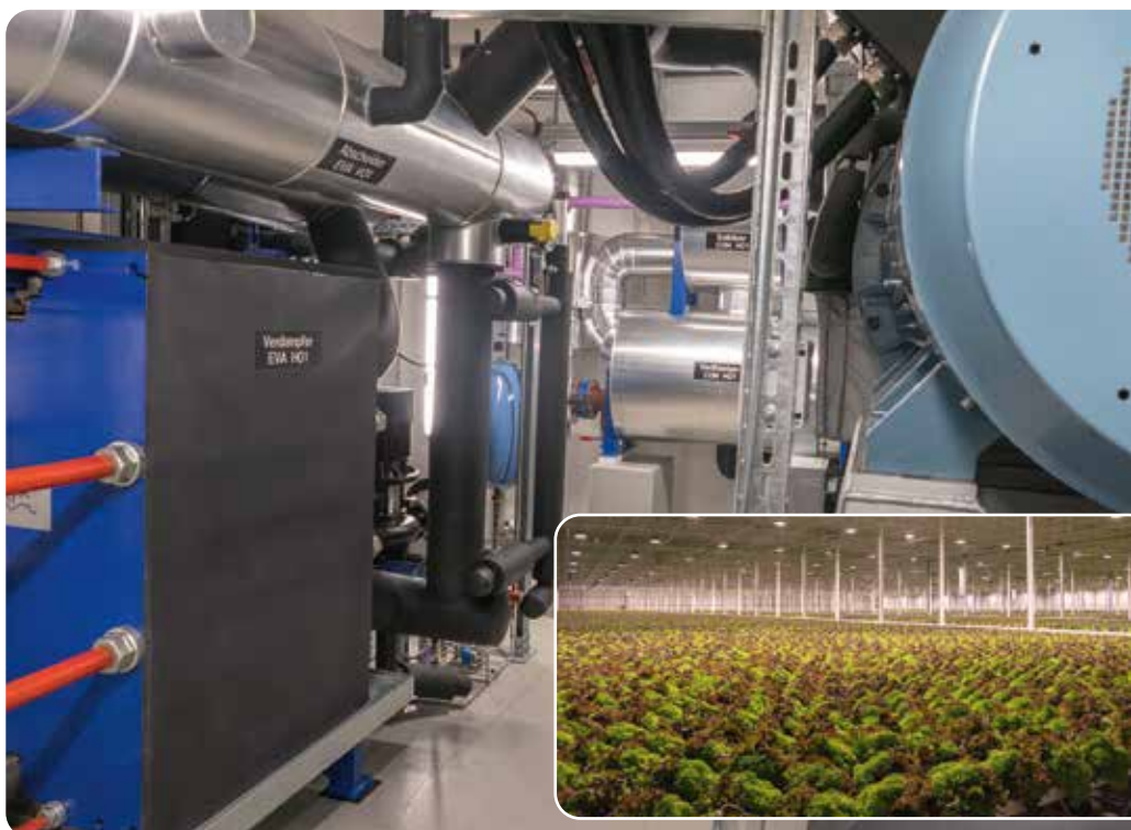
Im Technikraum produziert die Wärmepumpe die Wärme für die Gewächshäuser unter anderem mit den Hydrosalaten. DAVID EPPENBERGER
